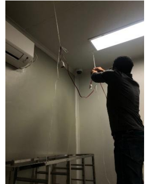
Pemasangan Lampu neon di ruang normal
