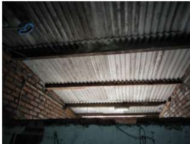
Gambar 4.6 Kondisi Atap Rumah Warga.
