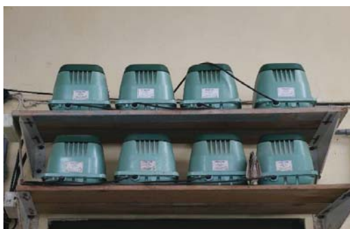
Blower untuk aerasi
