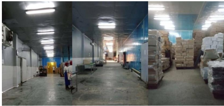
Gambar 7. Kondisi langit – langit dan dinding
