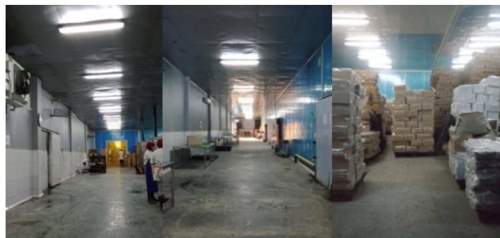
Gambar 7. Kondisi langit – langit dan dinding
