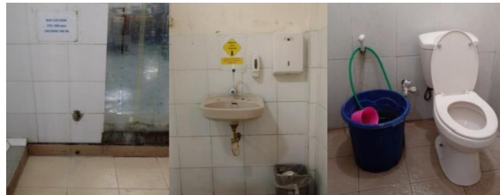
Gambar 12. Bak Cuci Kaki, Wastafel dan Toilet PT. Karya Mina Putra
