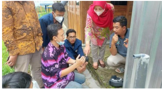
Gambar 4. Instalasi kran air otomatis untuk penghematan air
