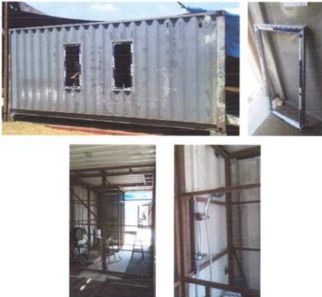
Gambar 4. Progres portable isolation container, frame jendela sudah terpasang, shower sudah di instal bracketnya, dan pemasangan frame interior terus berjalan
