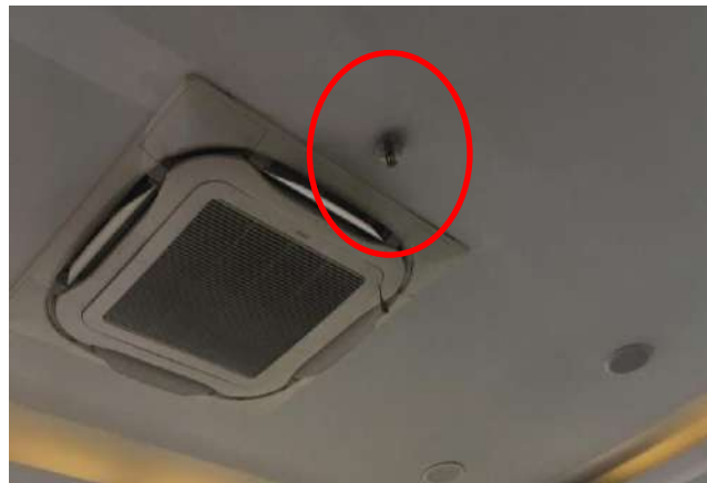
Gambar 4.10 Sprinkler di Rumah Sakit
