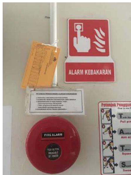
Gambar 4.7 Alarm Kebakaran di Rumah Sakit
