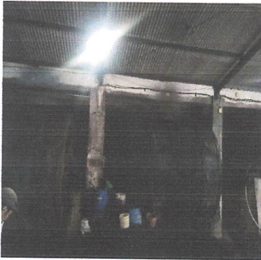
Ventilasi yang kurang dan lembab
