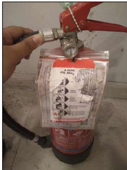
Gambar 4.21 Kondisi kartu APAR Hampir Rusak
