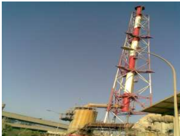
Gambar 4. 4 Cerobong Asap Stack D-1303 Sumber: PT Petrokimia Gresik
