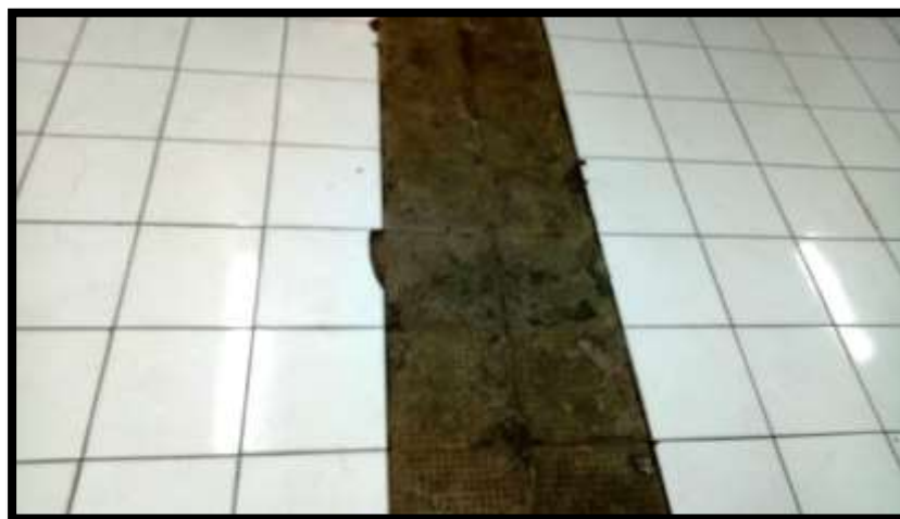
Gambar 4.8 Kondisi lantai di Ruangan Departemen Support
