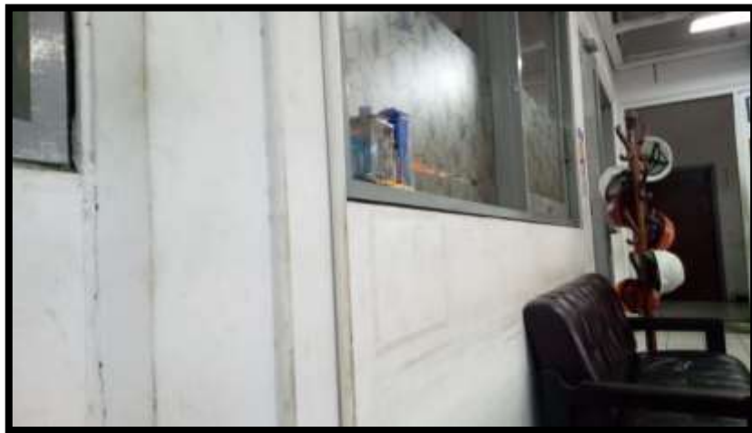
Gambar 4.9 Kondisi dinding di Ruangan Departemen Support
