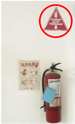
Lampiran 9.13 Tanda Pemasangan APAR Di Ruang Produksi Minyak Goreng Terbalik.
