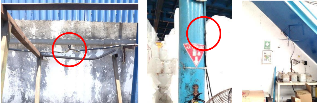
Lampiran 11.4 Kabel yang Terkelupas dapat Berpotensi Menyebabkan Korsleting Hingga Kebakaran.
