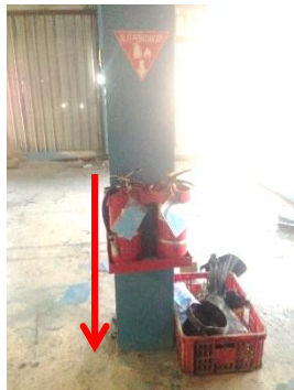
Lampiran 9.10 APAR Di Divisi Refinery Berada pada Ketinggian Lebih dari 120 cm.
