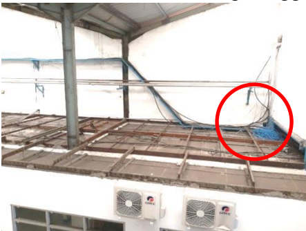
Lampiran 11.5 Kabel yang Berserakan dan Tidak Terlindungi Di Atas Plafon dapat Berpotensi Digigit Tikus dan Menyebabkan Korsleting Hingga Kebakaran.
