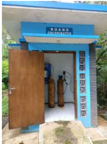
Gambar 4.5 Ruang Klorinasi Sumber Sumpersari
