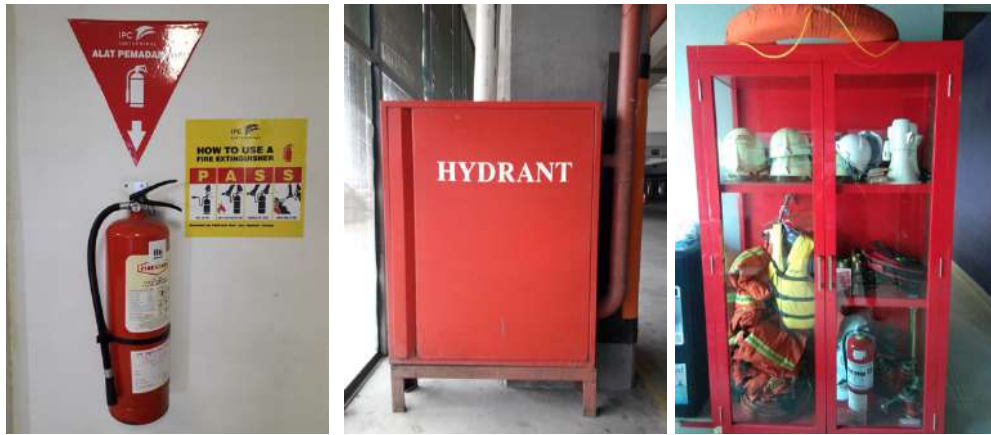
Gambar 4.3 APAR, Hydrant dan Lemari Tanggap Darurat
