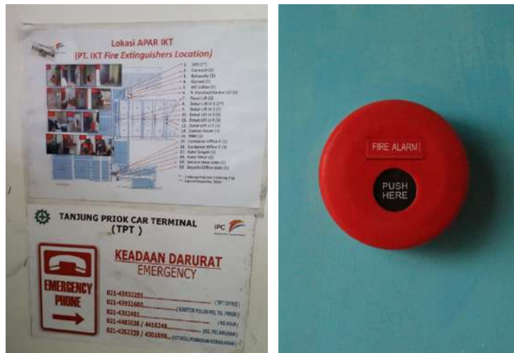
Gambar 4.4 Papan Lokasi APAR, Emergency Phone dan Fire alarm
