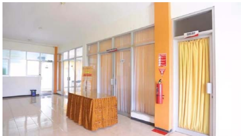
Gambar 4.16 Ruang terdapat APAR
