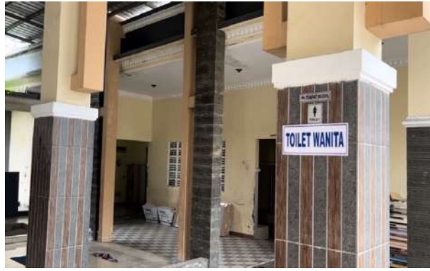
Gambar 4.36 Toilet/WC tidak dihubungkan langsung dengan bangunan utama
