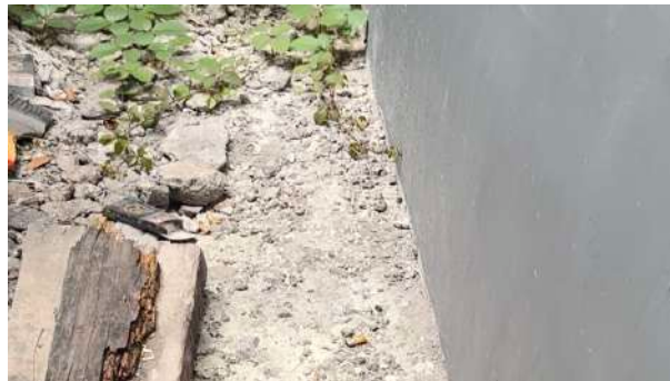
Gambar 4.27 Kondisi Pembuangan air limbah/kotor Masjid Riyadhus Salma
