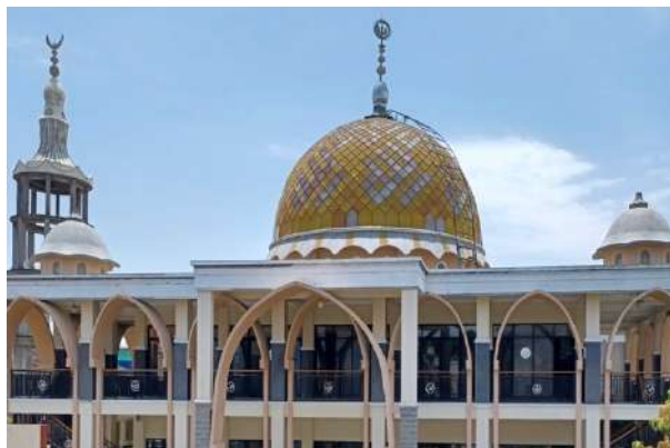
Gambar 4.21 Kondisi atap Masjid Riyadhus Salma
