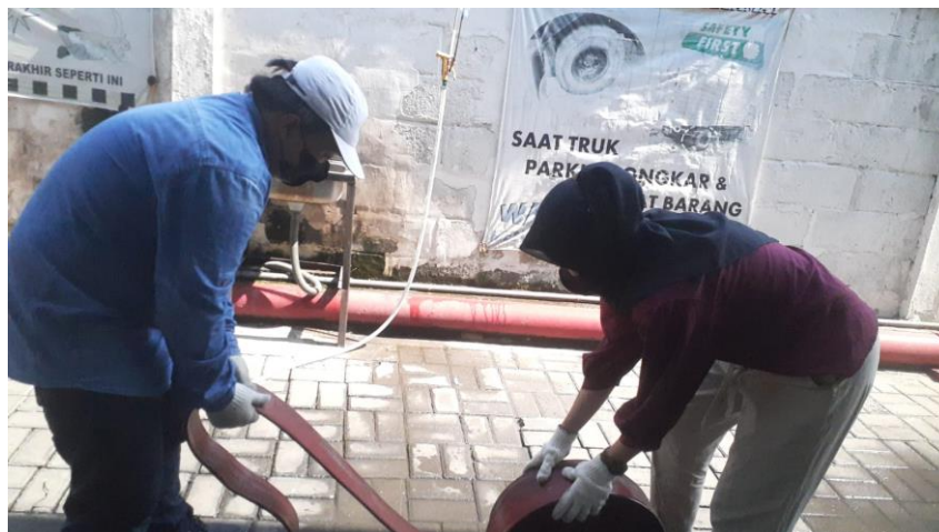
Dokumentasi Pengecekan hydrant setiap bulan
