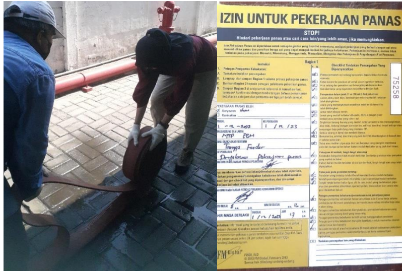
Gambar 4.7 Pengecekan Hydrant Bulanan dan Izin Kerja Panas
