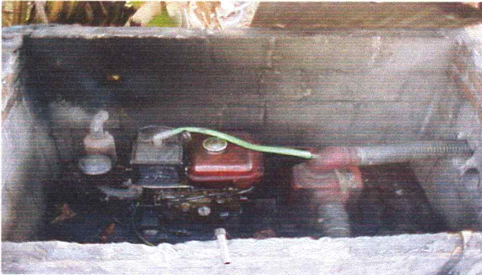
Gambar 2 Diesel digunakan untuk menyedot air dari sumur bor . . . berkekuatan 8 PK
