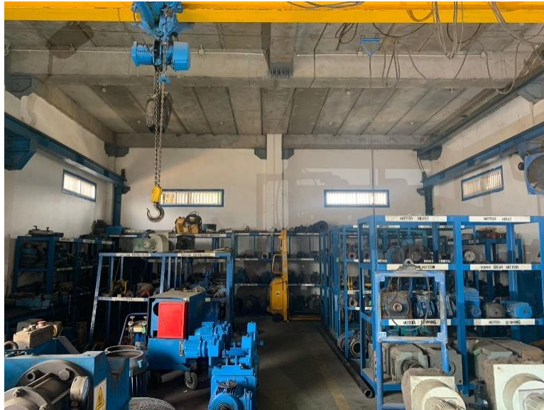
Gambar 4.9 Barang dan Material di area Workshop Peralatan telah dikelompokkan sesuai Jenisnya
