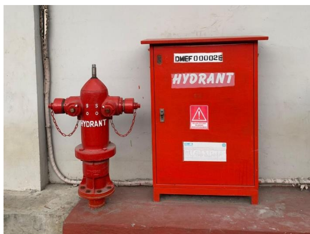
Gambar 4. 6 Hidran di PT Wijaya Karya Beton Tbk. Pasuruan
