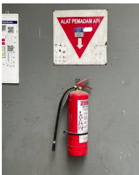
Gambar 4. 5 Alat Pemadam Api Ringan (APAR) di PT Wijaya Karya Beton Tbk. Pasuruan
