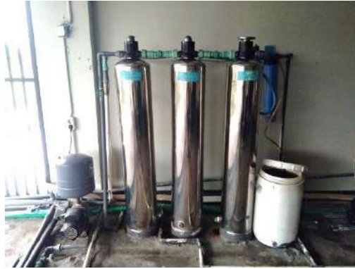
Gambar 4.3 Filter Pasir, Karbon dan Resin
