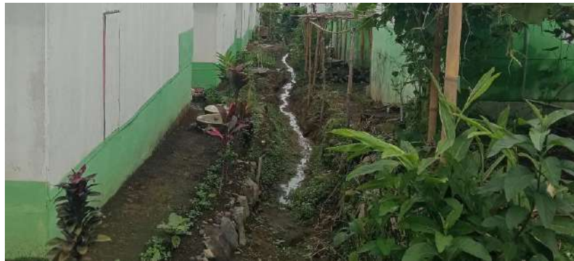
Gambar 4.6 Kondisi selokan belakang rumah
