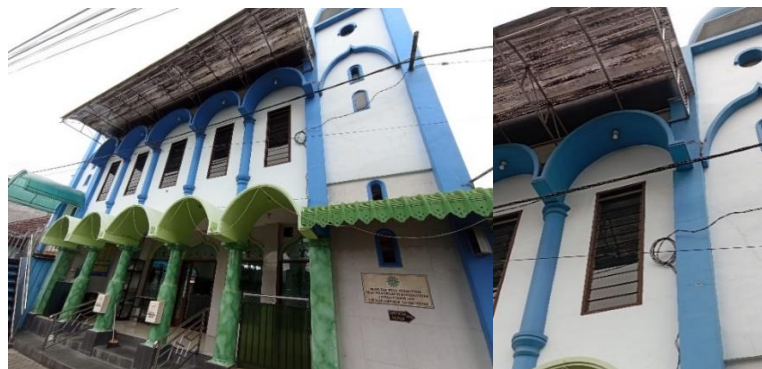
Gambar 4.8 Kondisi Atap Masjid
