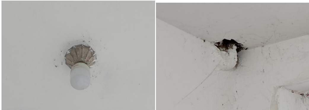
Gambar 4.5 Kondisi Langit Langit Masjid
