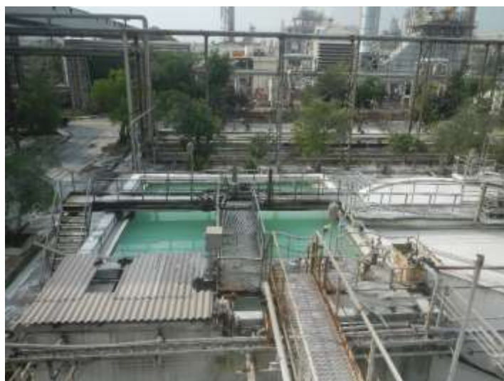
Hasil pengolahan limbah cair di Effluent Treatment atau air bersih dengan ph normal
