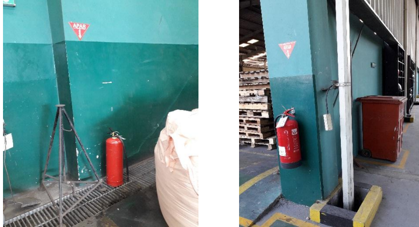
Gambar 4.4 Pemasangan APAR Sumber: Hasil Observasi, 2019
