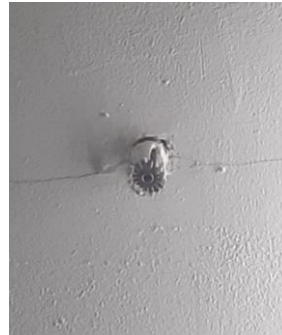
Gambar 4.20 Sprinkler Di Unit AD 1 Terkena Cat
