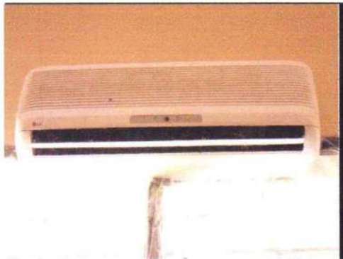
ruangan A yang dillengkapi dengan AC
