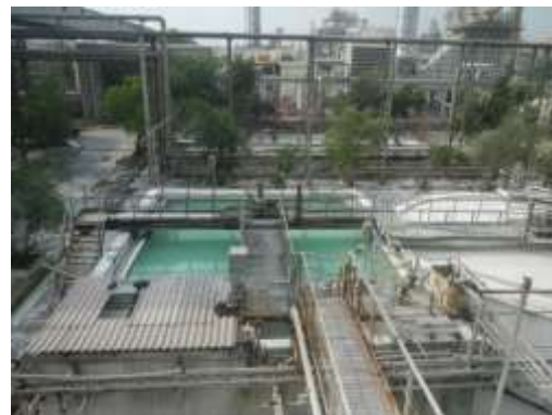
Gambar 6. Thickener II dan Penampungan treated water ET
