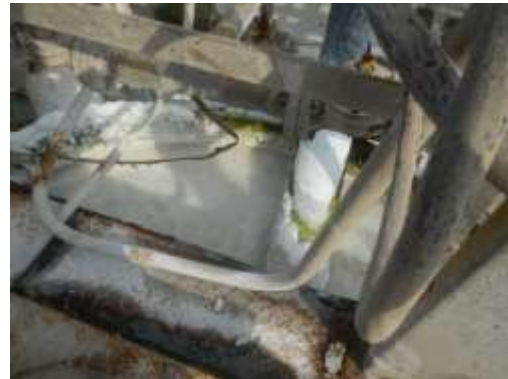
Gambar 4. Penambahan polymer pada Coagulation Tank
