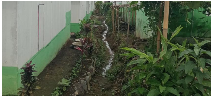
Gambar 4.7 Kondisi Selokan Belakang Rumah
