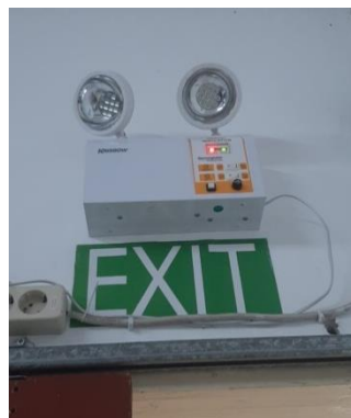
Gambar 4. 28 Emergency Lamp di PT ARPS
