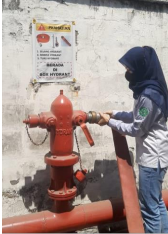
Melakukan pengecekan fire hydrant
