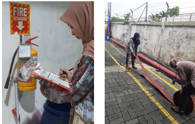
Gambar 4. 8 Pengecekan APAR (kiri) dan Box Hydrant (kanan)
