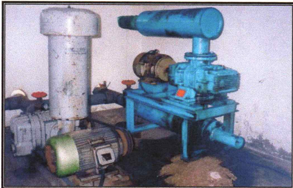
5.2. Root Blower sebagai Sumber Aerasi
