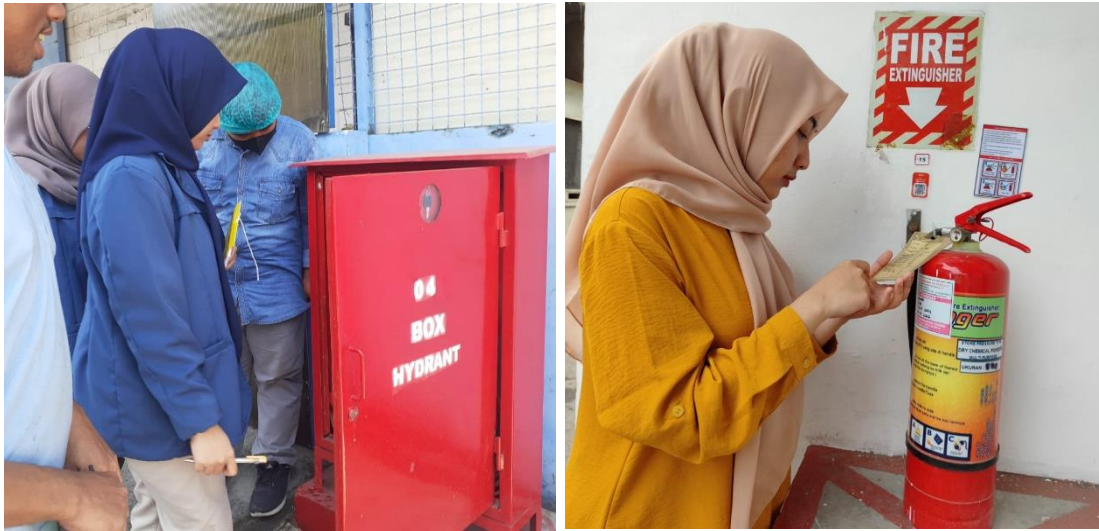
Gambar 5. 6 Pengecekan Hydrant dan APAR
