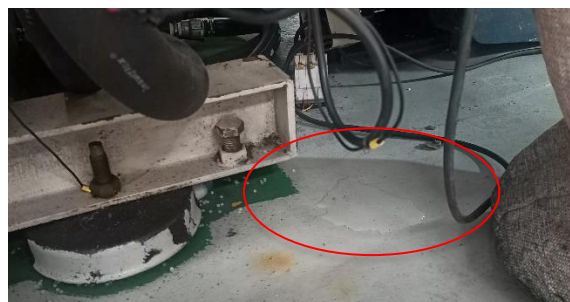
Gambar 4.29 Tetesan air di lantai dari selang Cooling Mold
