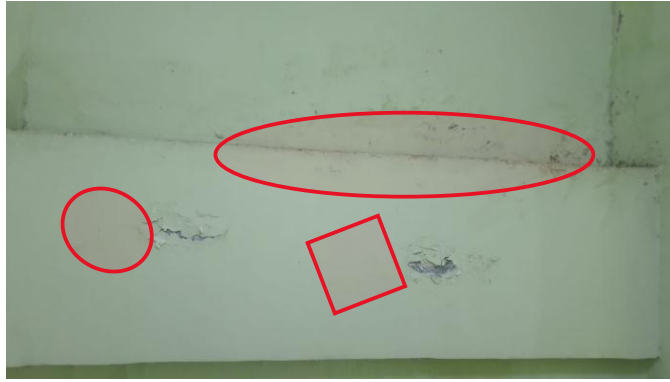
Gambar 4.46 Kondisi Dinding Area Tangga Lantai 2 RSMM Jawa Timur
