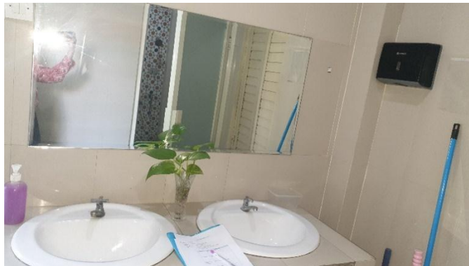
Gambar 4.53 Wastafel atau Tempat Cuci Tangan Toilet RSMM Jawa Timur
