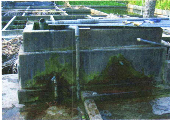
Gambar 6. Kolam pengendapan air sumur
