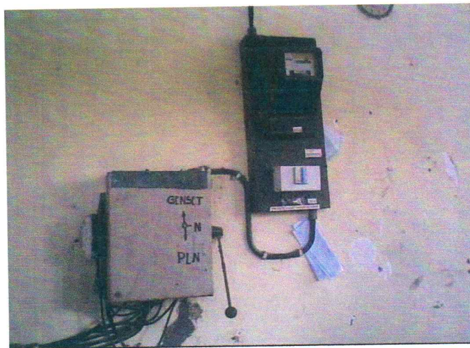
Meteran listrik dan saklar genset
