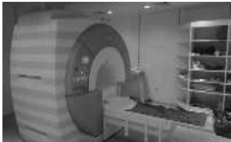
Gambar 3.1 Pesawat MRI Siemens Essenza 1,5 T pada Instalasi Radiologi RSUD Haji Surabaya
